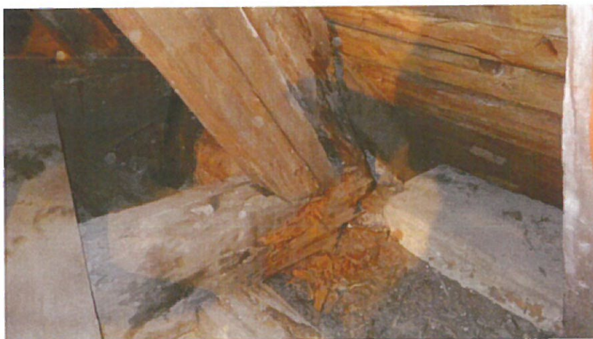
Fot. 11) Węzeł W-13/P – pełna korozja murłaty, końcówki krokwi i tramu oraz przypustnicy w wyniku zalewania wodą opadową.
