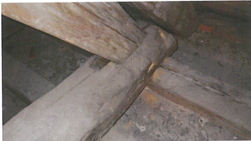
Fot.6) Węzeł W-4/P – ślady korozji końcowego odcinka tramu i murłaty, ślady żerowania owadów.
