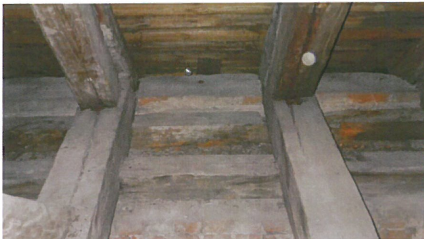
Fot. 16) Węzeł W-22/P – korozja murłaty.
