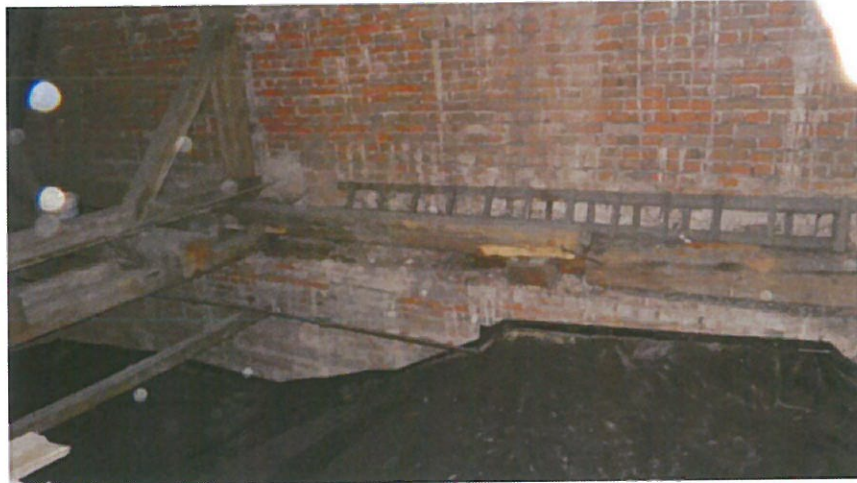
Fot.5) Węzeł W-1/P,L – uszkodzona i skorodowana belka tramowa, oparta na odsadźce muru.
