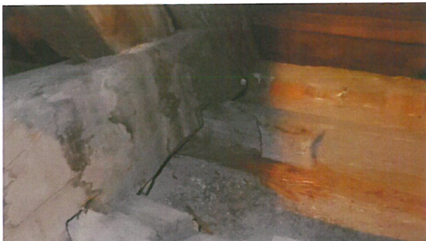
Fot.7) Węzeł W-5/P – pełna korozja murłaty w wyniku zalewania wodą opadową. Skręcona belka tramowa.
