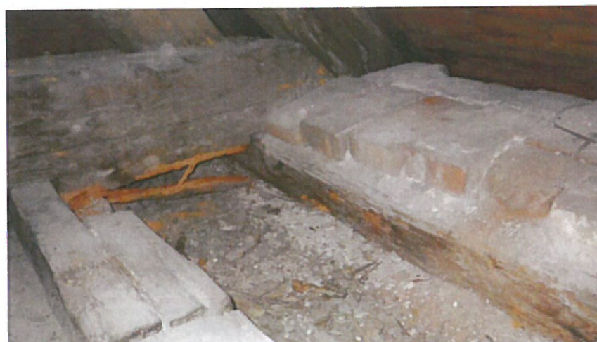
Fot.9) Węzeł W-11/P – pełna korozja murłaty i końcówki tramu w wyniku zalewania wodą opadową.
