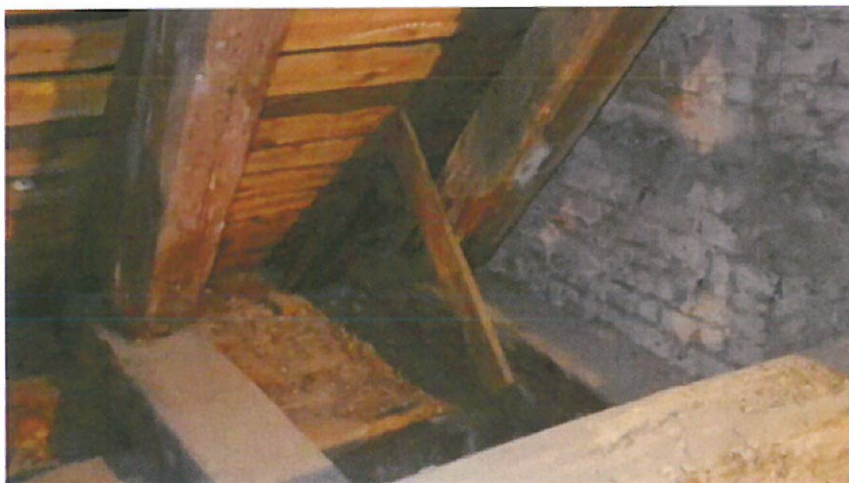
Fot. 17) Węzeł W-27/P (przy wieży zachodniej) – pełna korozja murłaty i przypustnicy.
