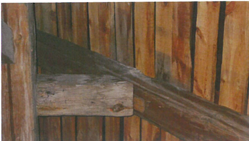
Fot. 10) Węzeł W-12/P – uszkodzenie węzła połączenia krokwi z jętką dolną – przesunięcie krokwi.
