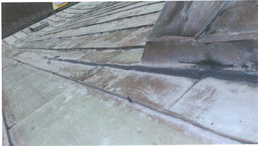
Fot. 23) Widok ogólny poszycia dachu z blachy. W miejscach zagięć liczne mikropęknięcia wzdłuż rąbków.
