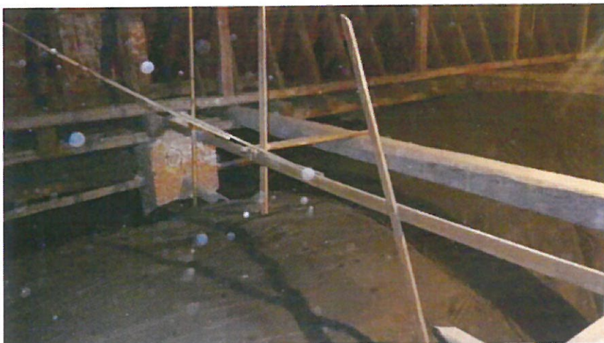
Fot.19) Ściana szczytowa południowa – prowizoryczna konstrukcja z desek utrzymująca zamknięte okno. Ruszt z wiotkich desek zaparty o sklepienie.
