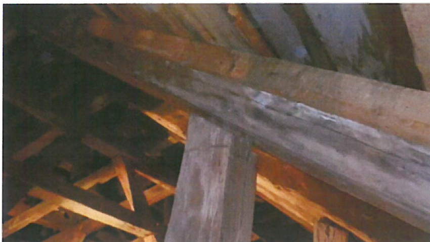
Fot. 13) Węzeł W-16/P – rozluźnione połączenie miecza stopowego i krokwi – przesunięcie krokwi.
